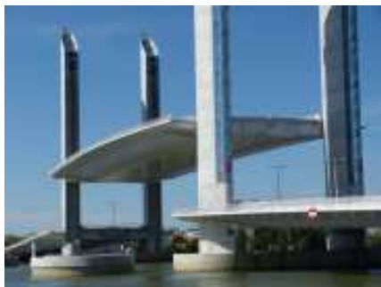
Grande profondeur de champ, zoom sur le tablier. Prise de vue depuis la rive droite.
